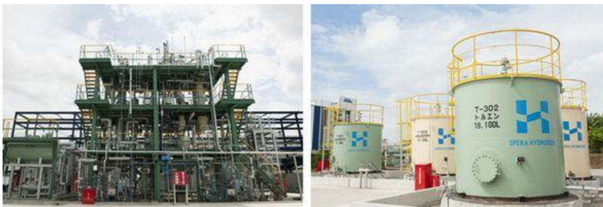
「大規模水素貯蔵・輸送システム」のデモプラント（左）と貯蔵タンク（右）」
