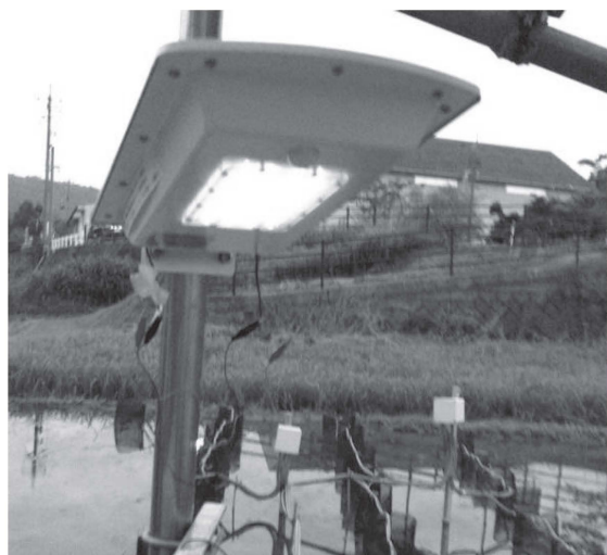
Fig.14. 微生物発電による街路灯点灯
