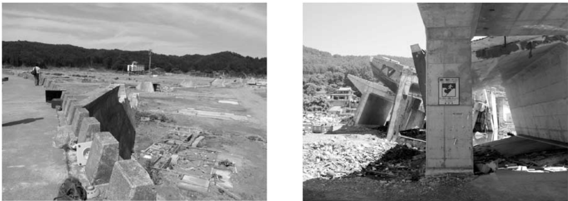
図1 宮古市田老地区（左）と釜石市唐丹小白浜地区（右）の防潮堤の被災状況
