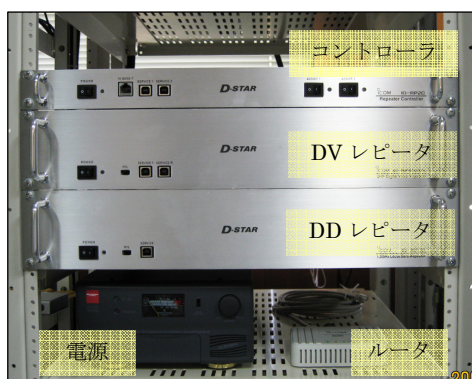
図 7 設置したレピータ機器
