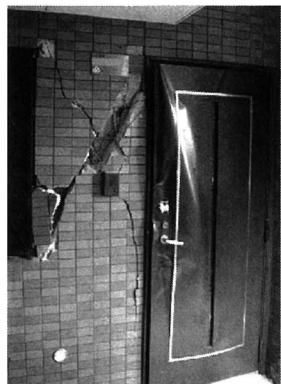
マンション被害(福岡市中央区)
