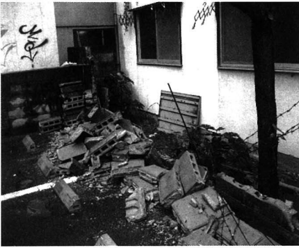
ブロック塀の倒壊 (福岡市中央区)
