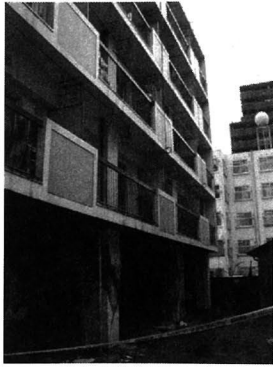
鉄筋アパートの被害(福岡市中央区)
